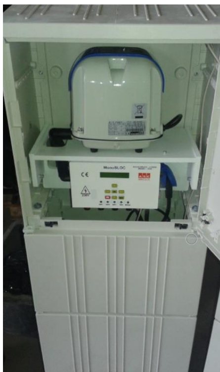
Szafa sterownicza oczyszczalni Eco – Cross
